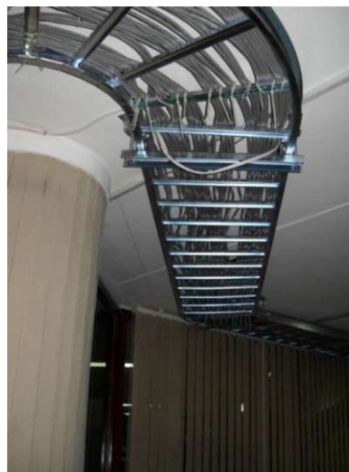
Nuevo cableado estructurado garantizado por un periodo de 20 años a partir de diciembre de 2010.
