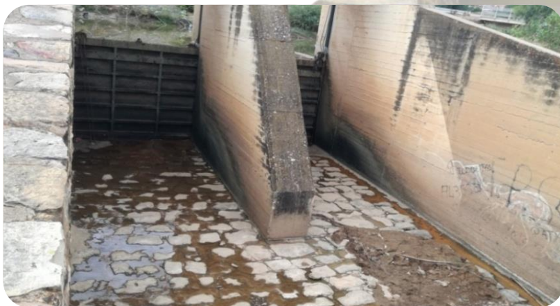
Compuertas de salida del agua hacia el río Tamborada en el sector de Santa Vera Cruz
