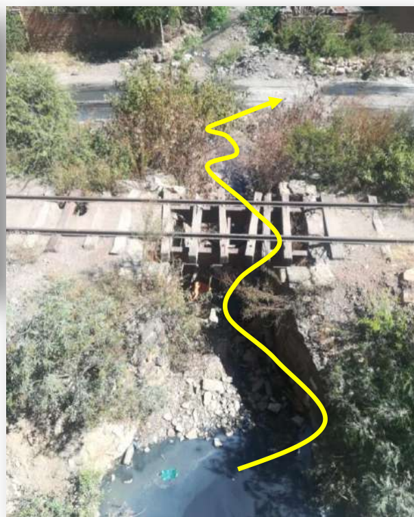
Agua residual que proviene de la filtración, acumulada en el canal pluvial ubicado por debajo de la Avenida Petrolera. El rebalse se dirige hacia el río Tamborada
