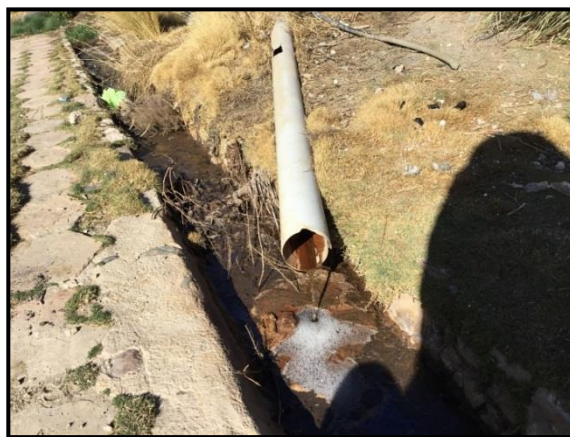
Imagen 13 Descarga de lixiviados a las piscinas
