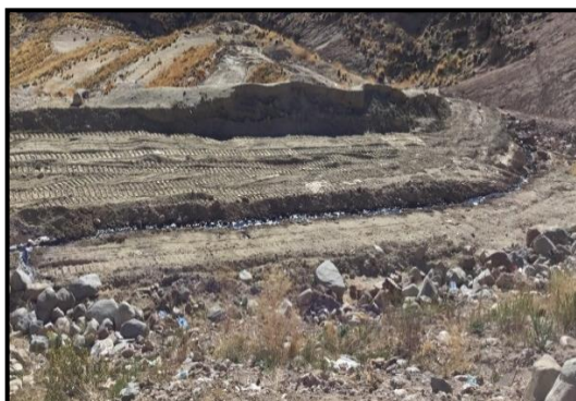
Imagen 5 Canaletas de captación de lixiviados
