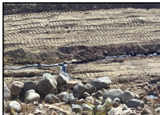
Imagen 6 Descarga de lixiviados a las canaletas
