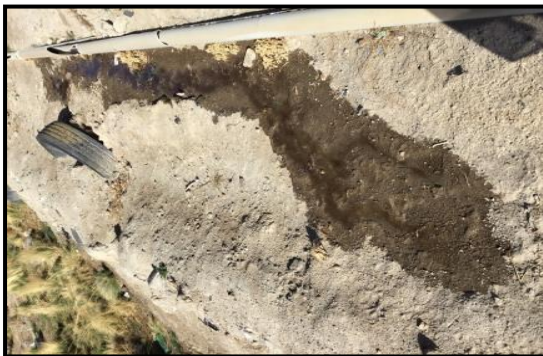
Imagen 11 Filtración de lixiviados
