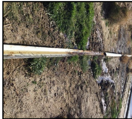
Imagen 10 Tuberías en mal estado
