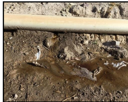
Imagen 12 Lixiviados en el suelo sin impermeabilización
