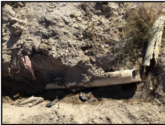
Imagen 9 Tuberías sin conexión
