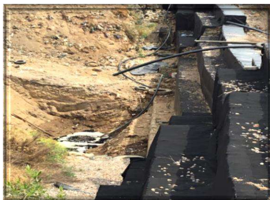
Fotografía 11. Descarga de lixiviados
