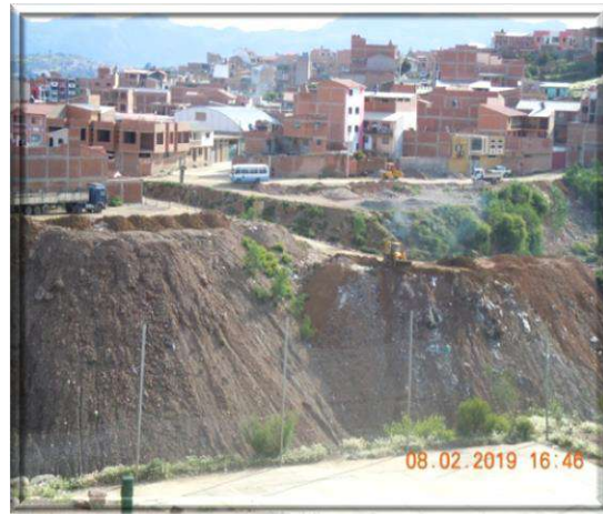
Fotografía 2. Disposición de escombros en riberas de río
