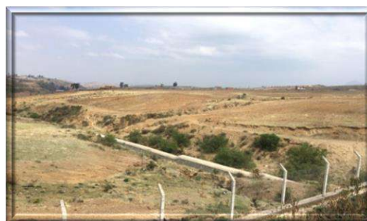
Fotografía 12. Embovedado de la quebrada La Esperanza
