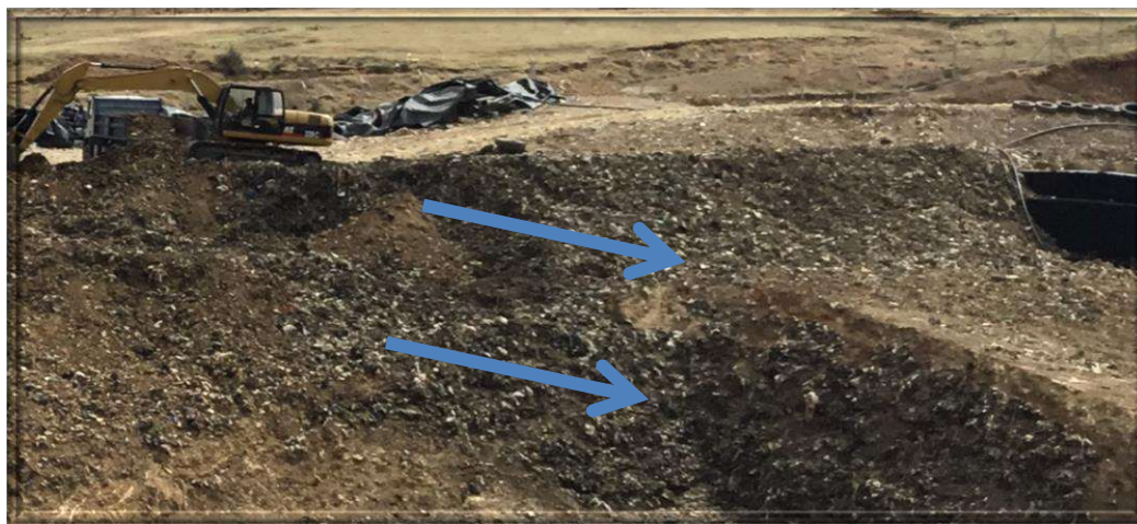
Fotografía 14. Talud sin drenes de captación
