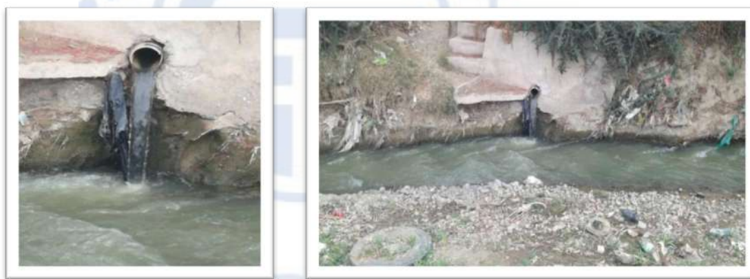
Descarga de agua tratada hacia el río Chijllawiri de la planta de tratamiento de EMBOL
