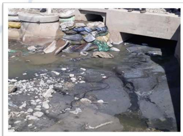
Segundo punto de descarga de agua residual no tratada proveniente del tanque séptico en la calle Retamas
