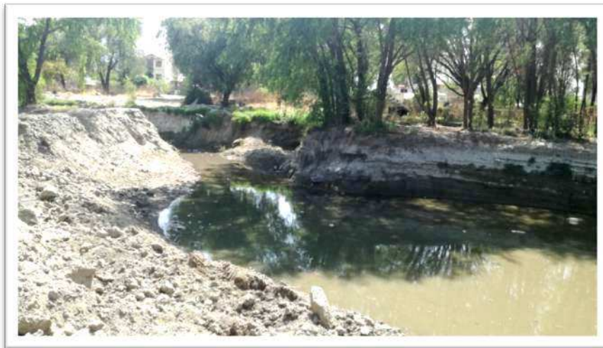
Desarenador, espacio que retiene la mayor parte de residuos sólidos que ingresan
