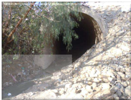
Descarga directa de aguas residuales domésticas al río Quirpinchaca
