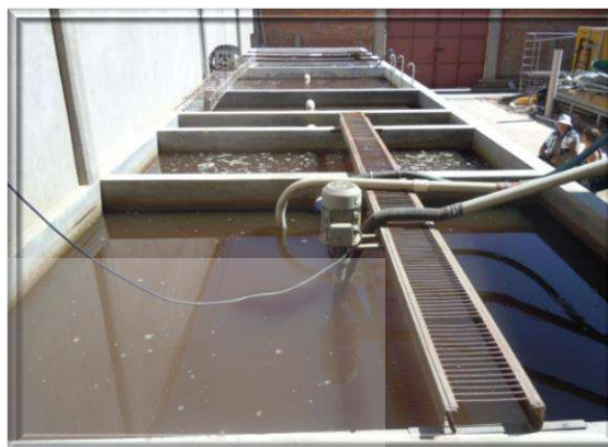
Piscina de sedimentación
