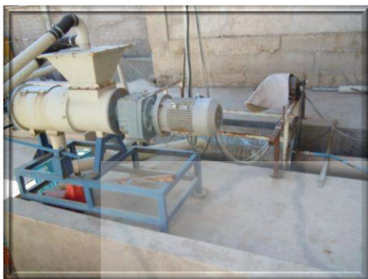
Filtro separador de sólidos
