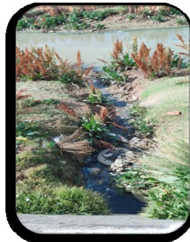
Descarga de aguas residuales domésticas en la Av. 16 de julio en el municipio de Viacha
