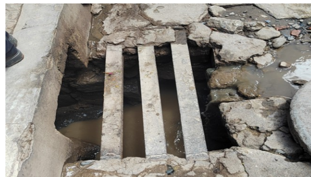
Boca de tormenta o sumidero
