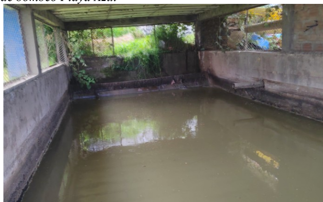
Tanque de almacenamiento
