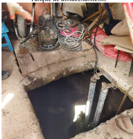
Sala de bombas
