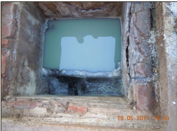
10.- Descarga de CURMA (cámara de inspección).
