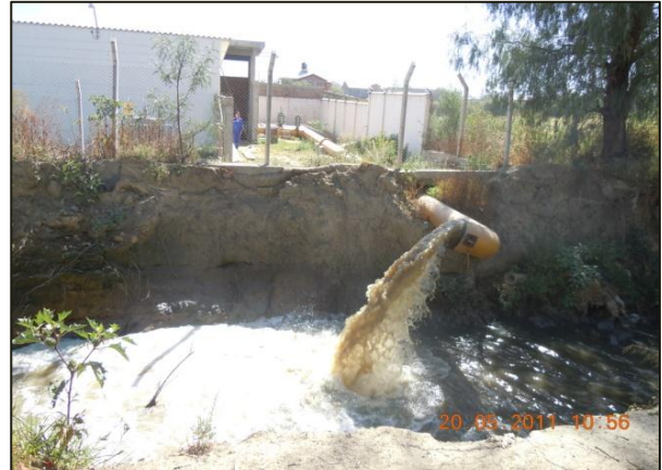
21.- Descarga de la planta elevadora Valverde.
