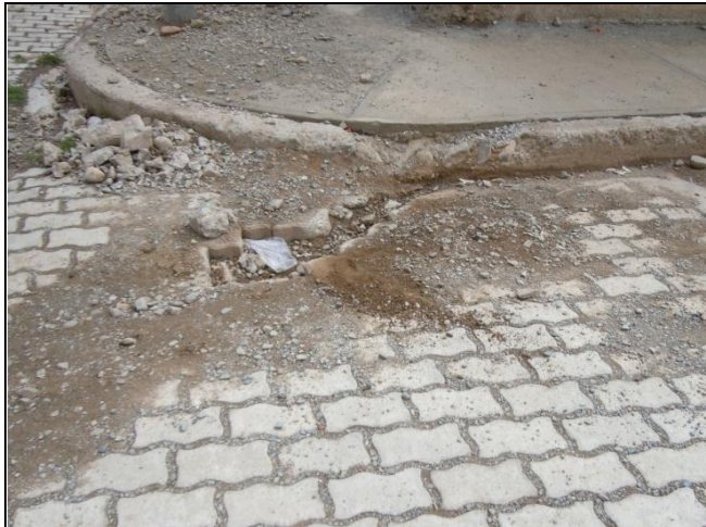
Foto N° 37: Calle Mario Guzmán Aspiazu – Destrozo de losetas para el desagüe pluvial y acumulación de tierra en la cuneta y calzada.
