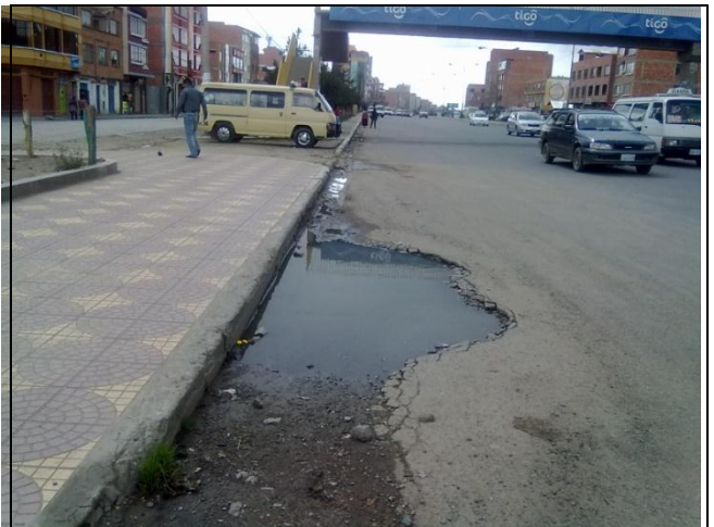
Foto N° 54: Av. Juan Pablo II – Bache en la calzada
