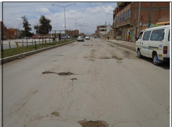
Foto N° 56: Av. Santa Vera Cruz – Baches múltiples en la calzada.
