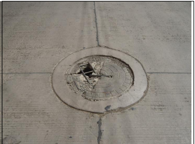
Foto N° 14: Calle José Ricardo Bustamante (Calle 21) – Tapa rota de cámara de inspección.
