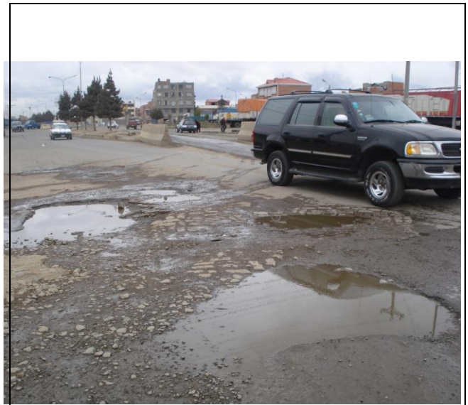
Foto N° 58: Av. Bolivia – Baches en la calzada y pérdida de la carpeta asfáltica.
