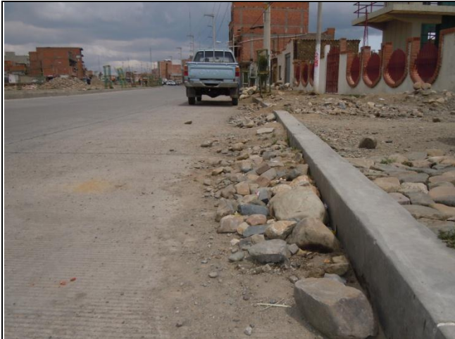
Foto N° 11: Av. Panorámica Sur – Acumulación de tierra y piedras al borde de la calzada.
