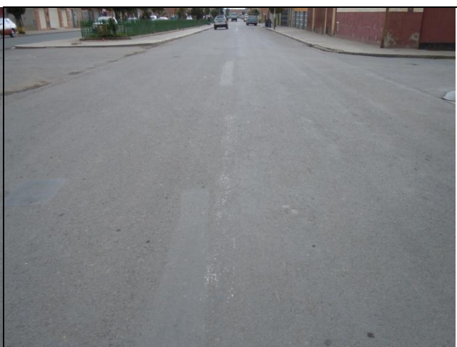
Foto N° 32: Av. La Paz – Divisoria de vía despintándose.
