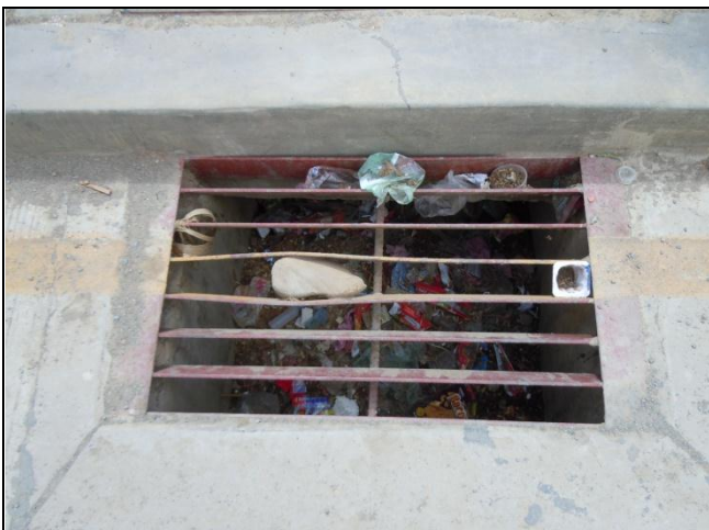
Foto N° 15: Av. Bautista Saavedra – Acumulación de basura en el sumidero.
