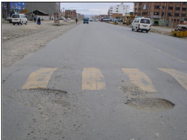
Foto N° 55: Av. Ladislao Cabrera – Bache en la calzada.
