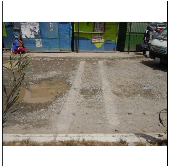
Foto N° 64: Av. Sucre – Sumidero transversal de calzada colmatado con material y pérdida de la capa asfáltica del paquete estructural de la vía.
