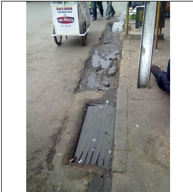
Foto N° 63: Av. 6 de marzo – Sumidero colmatado y deterioro de la cuneta.
