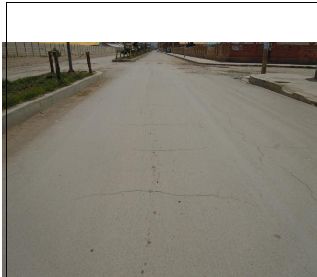
Foto N° 42: Av. Sucre – Fisuras Transversales que originan la aparición de fisuras en bloque.
