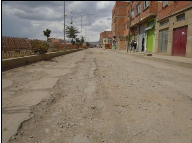
Foto N° 51: Av. Sucre – Pérdida de la Capa Asfáltica del paquete estructural de la vía.
