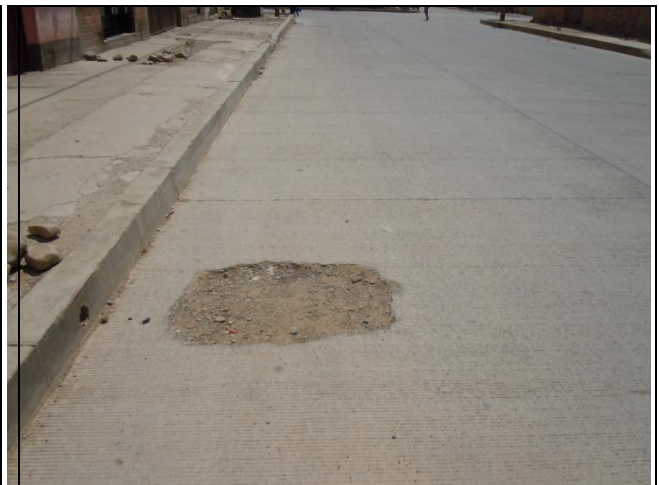
Foto N° 4: Av. Rio Guadalquivir – Bache en la calzada.
