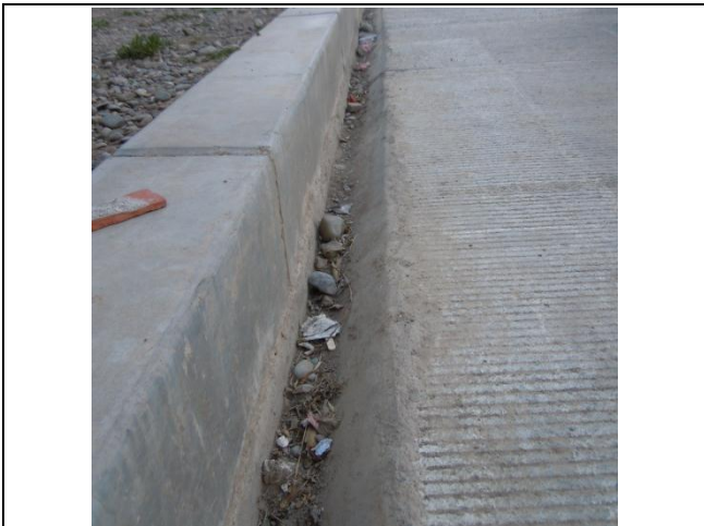
Foto N° 13: Av.Las Kantutas – Acumulación de tierra y basura en la cuneta.
