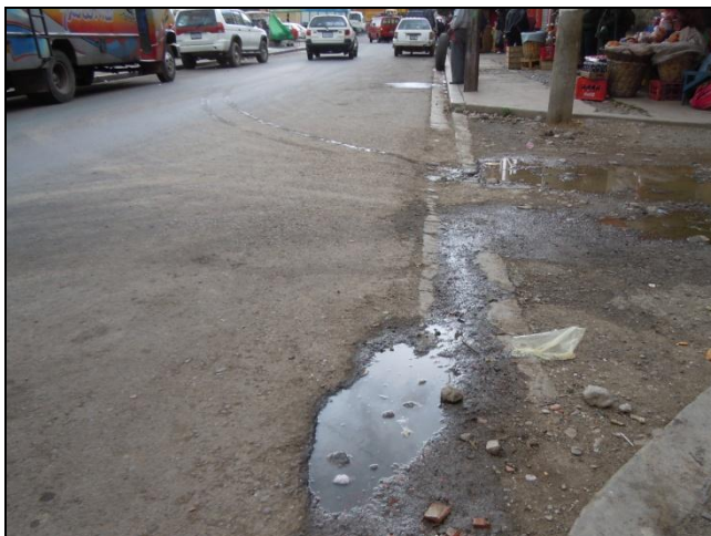
Foto N° 30: Av. La Paz – Bache al borde de la calzada y la cuneta, con acumulación de escombros.
