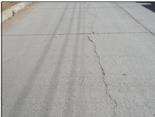
Foto N° 70: Av. Tiahuanacu – Grieta longitudinal con desportillamiento.
