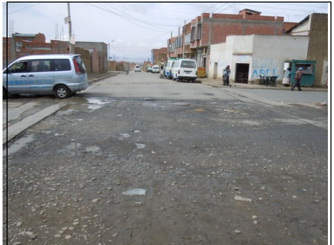
Foto N° 24: Av. Adrian Castillo – Pérdida de la Capa Asfáltica del paquete estructural de la vía en una intersección.
