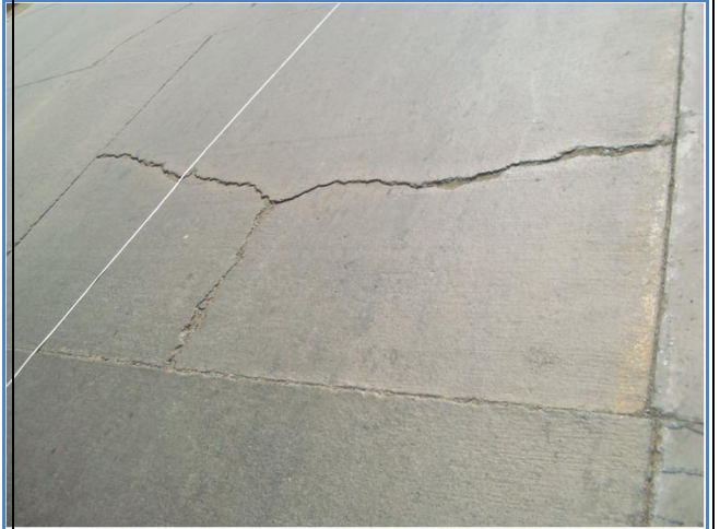
Foto N° 74: Av. Costanera – Grieta transversal y de esquina con desportillamiento en la grieta. Losa con asentamiento.
