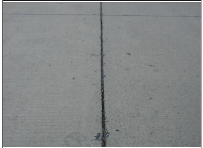
Foto N° 2: Av. Cornelio Saavedra – Falta de sello en la junta longitudinal.
