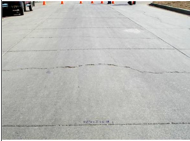
Foto N° 73: Av. Litoral (vía izquierda) – Grieta transversal con desportillamiento.
