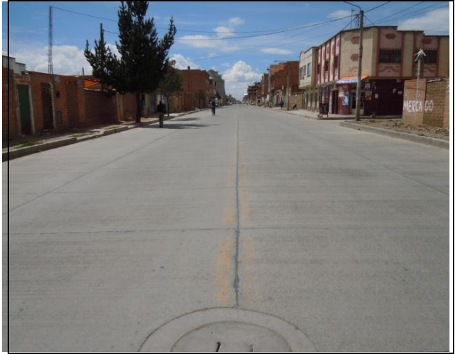
Foto N° 18: Av. Argelia – Divisoria de vía despintándose.
