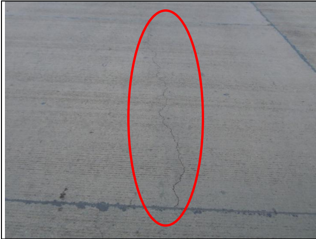
Foto N° 5: Av. Argelia – Fisura longitudinal.
