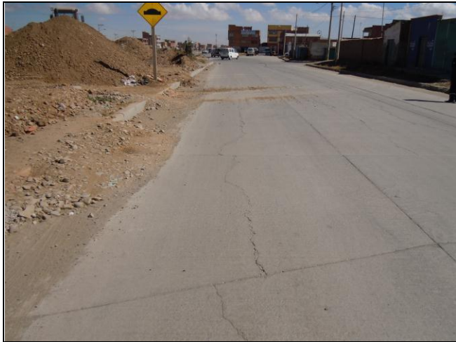
Foto N° 85: Av. Litoral (vía derecha) – Acumulación de tierra al borde de la calzada y en la cuneta.
