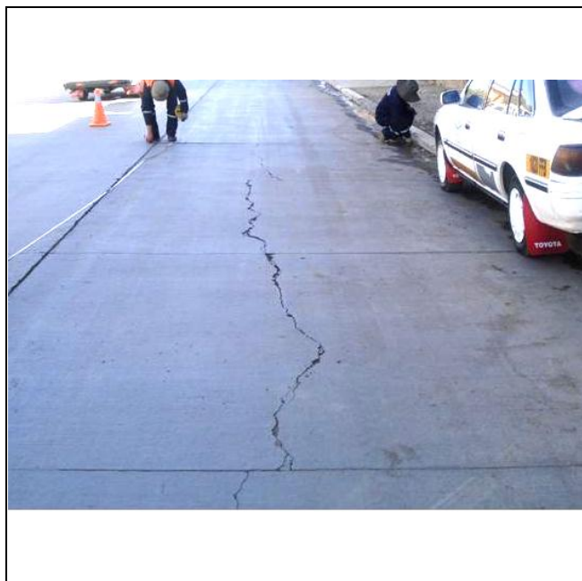
Foto N° 71: Av. Unión – Grieta longitudinal con desportillamiento.
