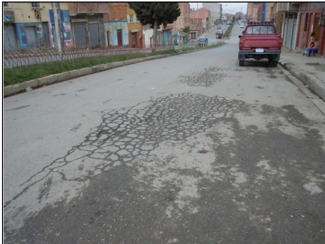
Foto N° 23: Av. Adrian Castillo – Fisuras Piel de Cocodrilo en la calzada con hundimiento.
