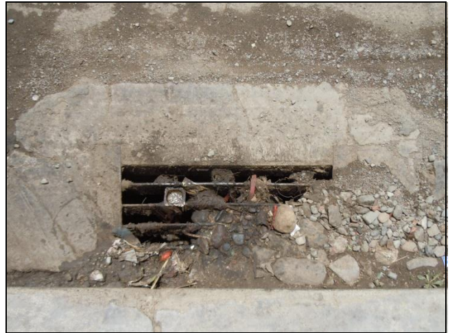
Foto N° 62: Av. Santa Vera Cruz – Acumulación de material y basura en sumidero.
