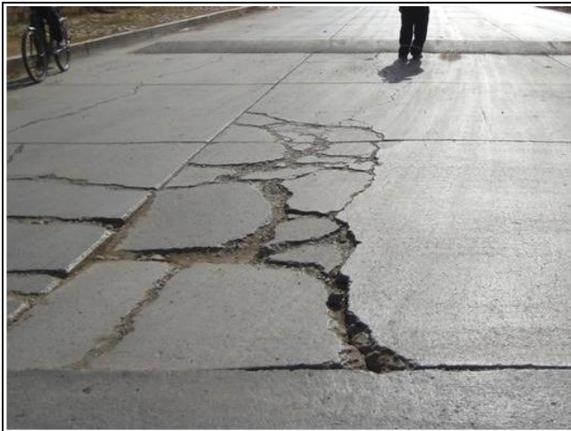
Foto N° 81: Av. Litoral (vía izquierda) – Grietas en bloque con fragmentación de losas, desportillamiento y escalonamiento en la grieta, escalonamiento de junta longitudinal y hundimientos de áreas de losa.
