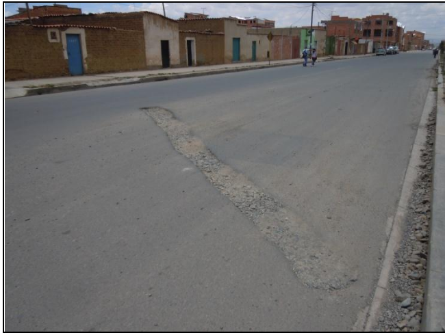
Foto N° 19: Av. Gral. Germán Busch – Bache en la calzada, por conexión domiciliaria.
