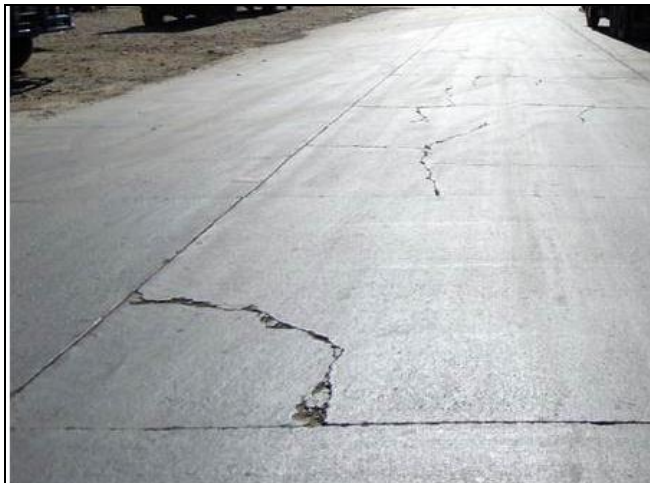
Foto N° 75: Av. Litoral (vía derecha) – Grieta de esquina y grietas en bloque con desportillamiento en las grietas.
