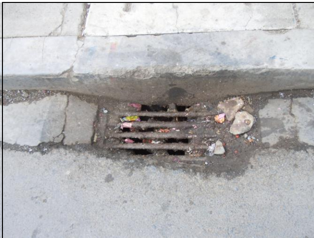
Foto N° 27: Av. La Paz – Acumulación de material y basura en sumidero.
