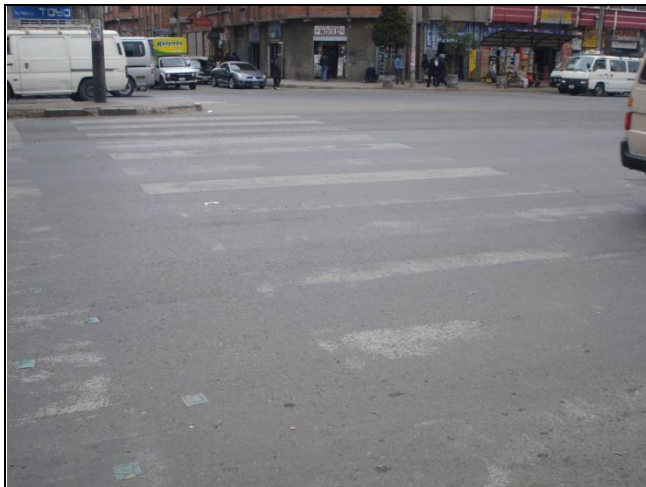
Foto N° 67: Av. 6 de Marzo – Paso de cebra despintándose.
