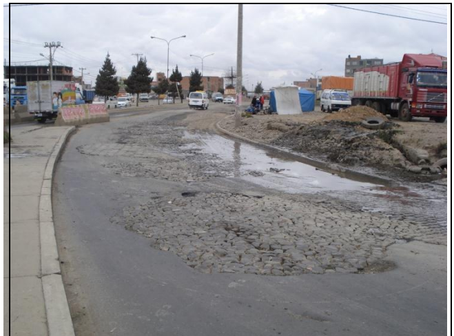
Foto N° 60: Av. Bolivia – Baches rellenados con piedra bolón y losetas con hundimiento en los mismos, y lodazales en el borde de la vía.
