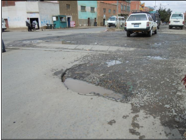
Foto N° 21: Av. Adrian Castillo – Bache en la calzada.
