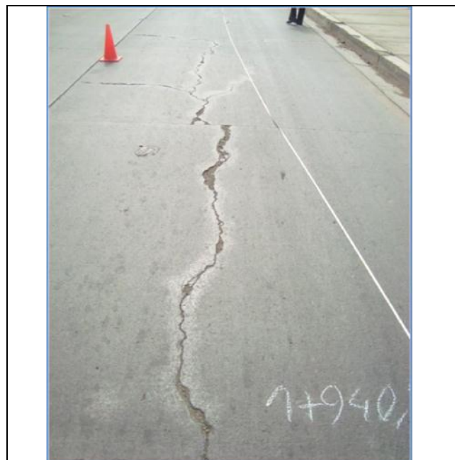
Foto N° 72: Av. Costanera – Grieta longitudinal con desportillamiento en la grieta.
