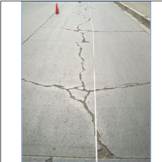
Foto N° 79: Av. Costanera – Grietas en bloque con desportillamiento y escalonamiento en la grieta.
