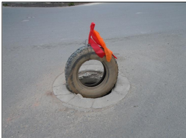
Foto N° 29: Av. Gral. Germán Busch – Tapa rota de la cámara de inspección que no fue repuesta.
