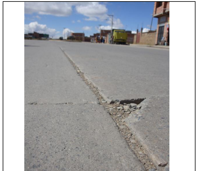
Foto N° 84: Av. Litoral (vía izquierda) – Pérdida del sello de la junta longitudinal y transversal, y escalonamiento de junta longitudinal.
