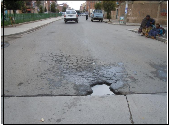
Foto N° 22: Av. La Paz – Fisuras Piel de Cocodrilo y bache en la calzada.
