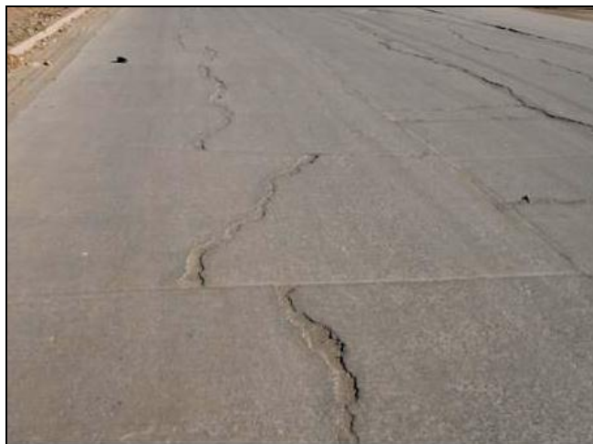
Foto N° 69: Av. Litoral (vía derecha) – Grieta longitudinal con desportillamiento y escalonamiento en la grieta.
