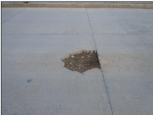
Foto N° 3: Av. Santiago de Machaca – Bache en la calzada.
