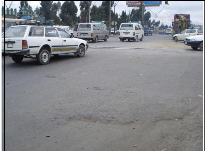
Foto N° 46: Av. 6 de Marzo – Abultamiento de la capa asfáltica.
