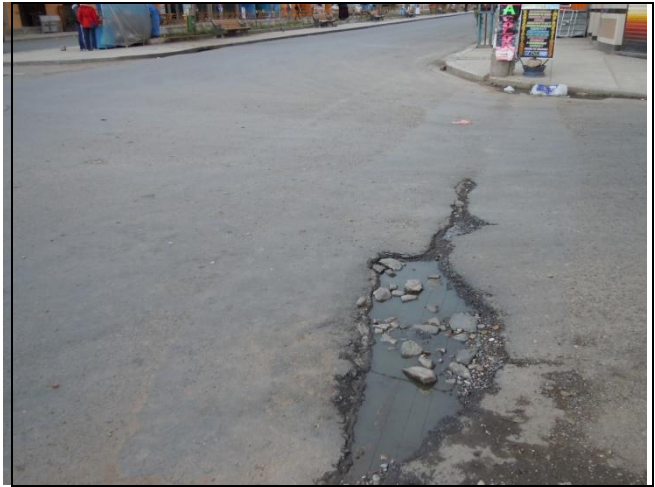
Foto N° 20: Av. La Paz – Bache en bocacalle.
