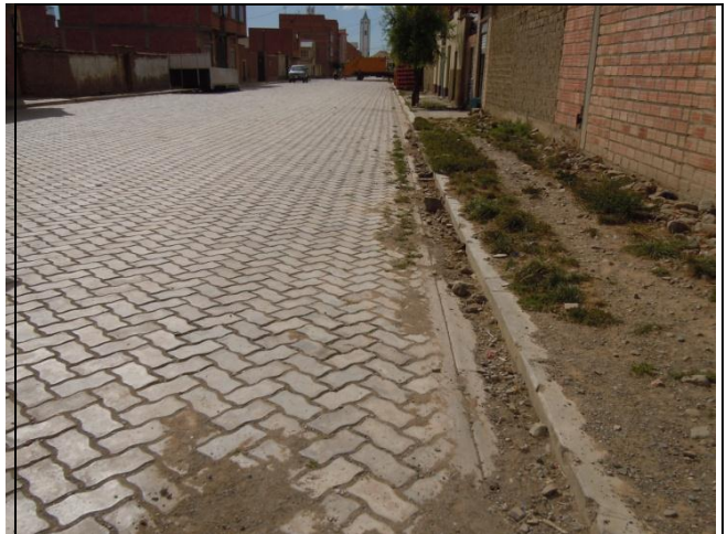
Foto N° 36: Calle Sacaba 12 – Acumulación de tierra en la cuneta.
