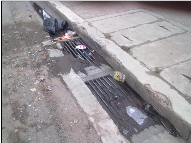
Foto N° 61: Av. Juan Pablo II – Sumideros colmatados de tierra y basura.
