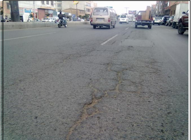
Foto N° 52: Av. Juan Pablo II – Pérdida de la Capa Asfáltica del paquete estructural de la vía y grietas en bloque.
