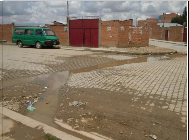
Foto N° 38: Av. Tupungato – Acumulación de material y basura en la calzada.
