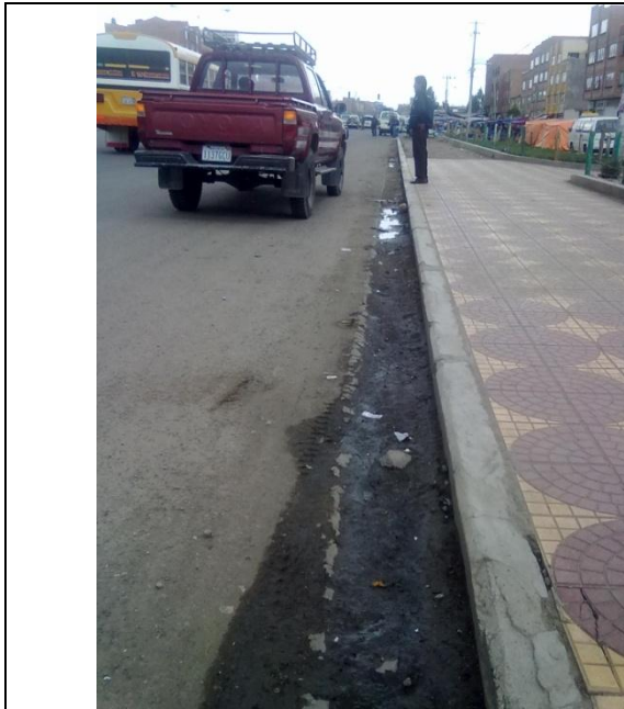
Foto N° 65: Av. Juan Pablo II – Acumulación de tierra en la cuneta.
