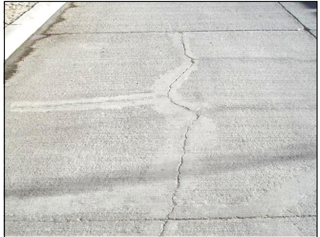
Foto N° 78: Av. Unión – Grietas en bloque con desportillamiento y escalonamiento en la grieta.
