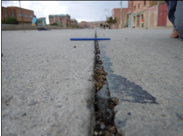
Foto N° 1: Av. Cornelio Saavedra – Escalonamiento de junta longitudinal y Falta de sello de juntas.
