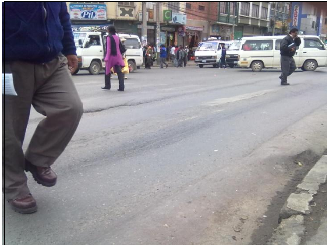
Foto N° 45: Av. 6 de Marzo – Ondulaciones y Ahuellamiento de la capa asfáltica.
