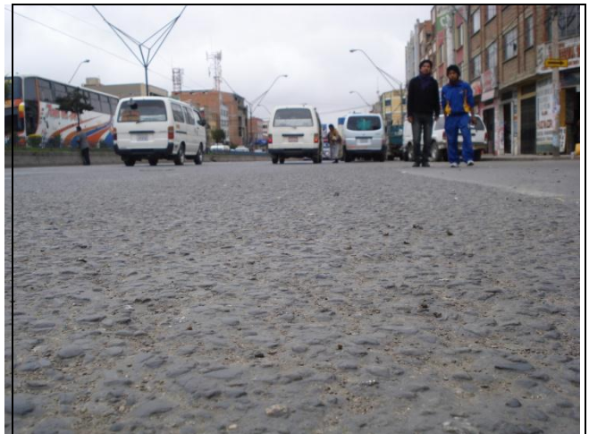
Foto N° 48: Av. 6 de Marzo – Desgaste Superficial de la capa asfáltica de la vía.
