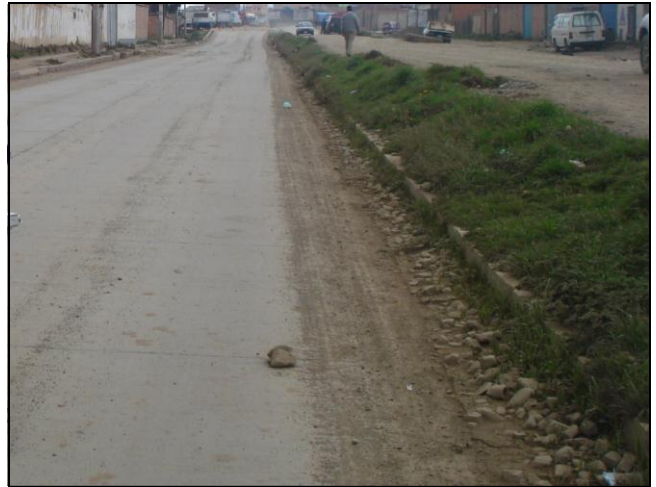
Foto N° 86: Av. Tiahuanacu – Acumulación de tierra al borde de la calzada y en la cuneta con presencia de vegetación.
