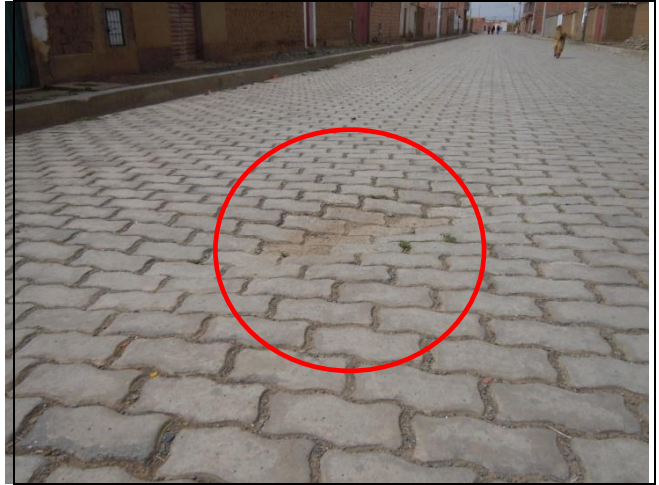
Foto N° 34: Calle Topater – Depresión en la calzada.
