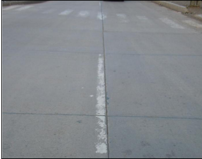
Foto N° 17: Av. Santiago de Machaca – Paso de cebra despintándose.
