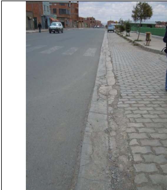
Foto N° 25: Av. Gral. Germán Busch – Deterioro de Cunetas.
