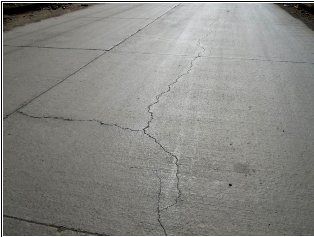
Foto N° 77: Av. Tiahuanacu – Grietas en bloque con desportillamiento y escalonamiento en la grieta.
