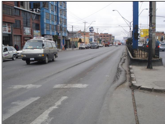
Foto N° 47: Av. 6 de Marzo – Deslizamiento de capas y ahuellamiento de la capa asfáltica.
