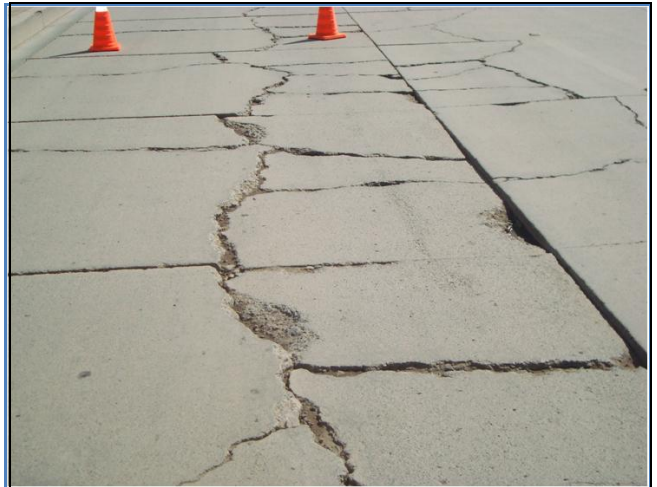
Foto N° 82: Av. Costanera – Grietas en bloque con fragmentación de losas, desportillamiento y escalonamiento en la grieta, escalonamiento de junta longitudinal y hundimientos de áreas de losa.
