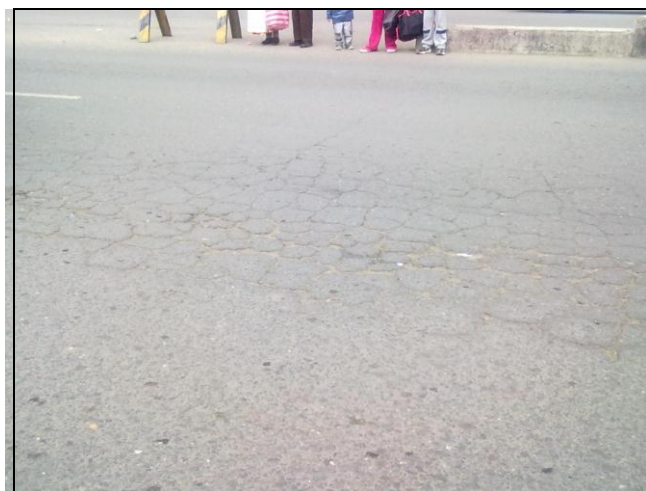
Foto N° 44: Av. Juan Pablo II – Fisuras Piel de Cocodrilo en la calzada.
