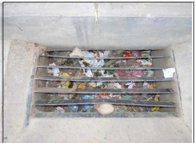
Foto N° 16: Av. Adela Zamudio – Acumulación de material y basura en el sumidero.
