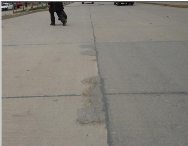
Foto N° 9: Av. Kollasuyo – Descascaramiento del pavimento.
