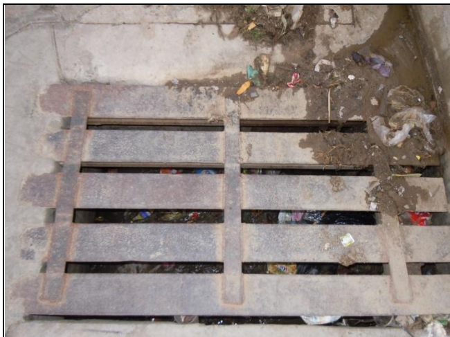
Foto N° 39: Avenida Arapata – Acumulación de material y basura en el sumidero.
