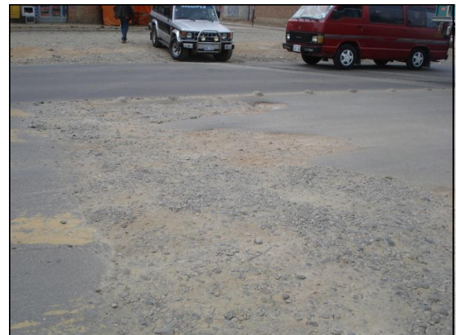
Foto N° 50: Av. Ladislao Cabrera – Pérdida de la Capa Asfáltica del paquete estructural de la vía.
