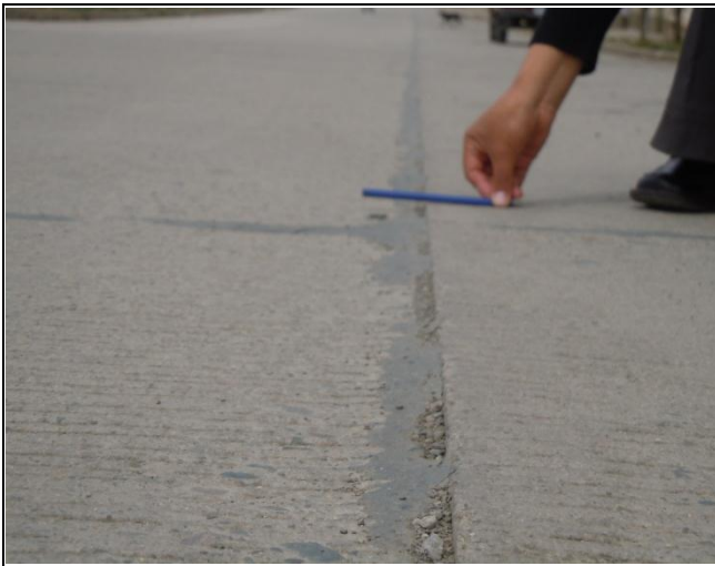
Foto N° 7: Av. Kollasuyo – Asentamiento en un sector de la losa.
