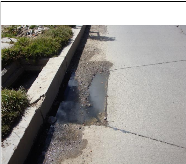
Foto N° 83: Av. Litoral (vía izquierda) – Sumidero colmatado de tierra y basura. Acumulación de tierra al borde de la calzada y en la cuneta.
