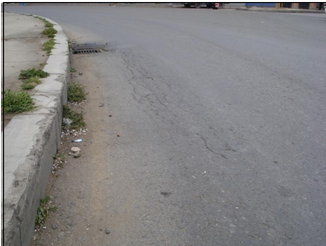
Foto N° 59: Av. Bolivia – Hundimiento de la capa asfáltica de la vía.
