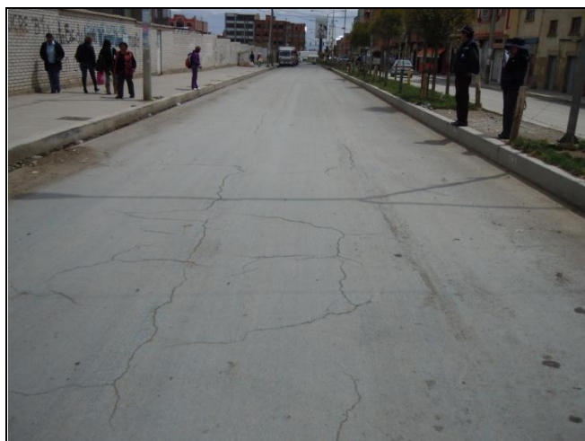
Foto N° 43: Av. Sucre – Fisuras de Bloque en la capa asfáltica.
