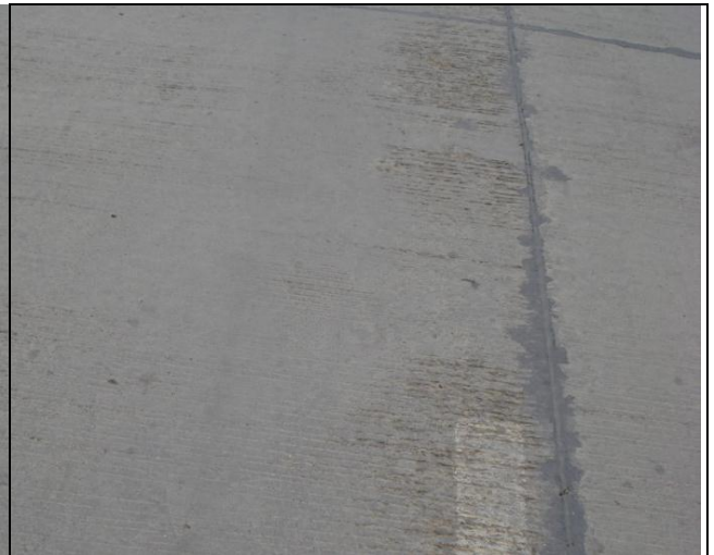
Foto N° 8: Av. Álvarez Plata – Desgaste superficial del pavimento (Pulimento).
