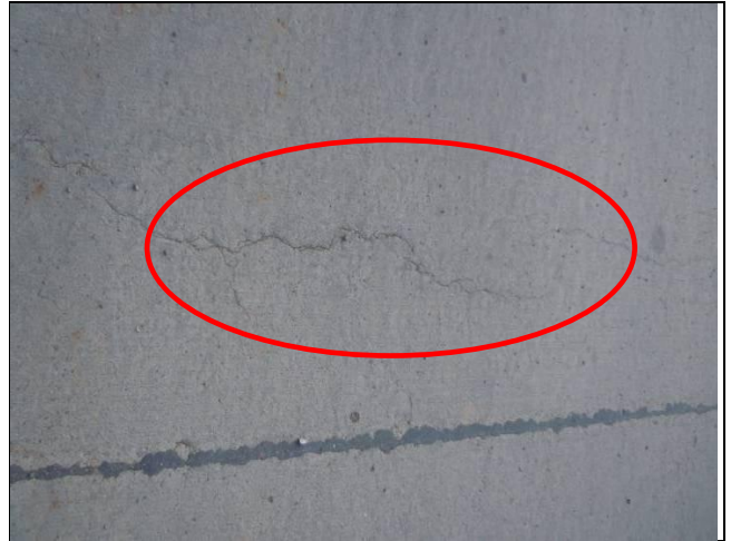
Foto N° 6: Av. Santiago de Machaca – Fisura transversal.
