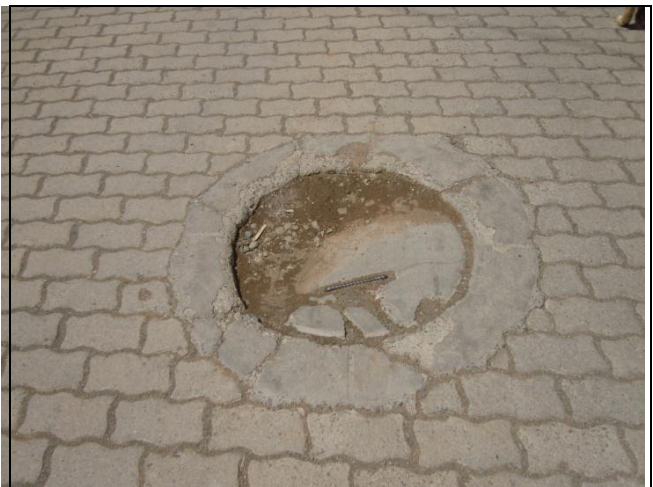
Foto N° 40: Avenida Abrojo – Tapa rota de cámara de inspección.
