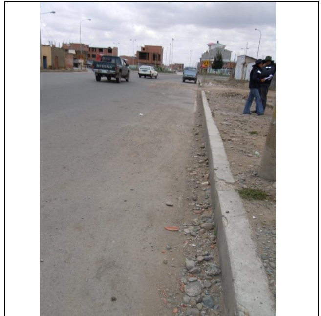
Foto N° 26: Av. Gral. Germán Busch – Material acumulado en la cuneta.
