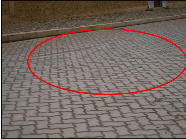
Foto N° 33: Avenida Arapata – Ahuellamiento en la calzada.
