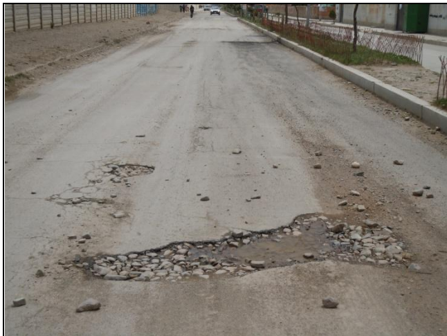
Foto N° 53: Av. Sucre – Bache en la calzada.
