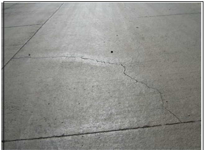
Foto N° 76: Av. Tiahuanacu – Grieta de esquina.
