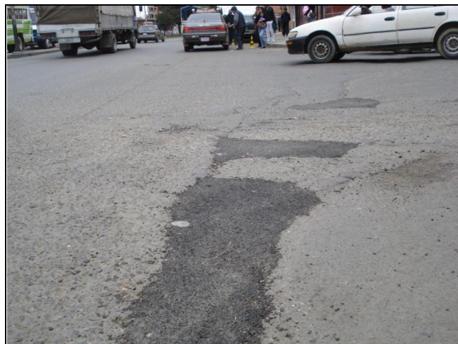
Foto N° 49: Av. Bolivia – Desgaste superficial de la capa asfáltica y parches con asfalto en frio al borde de la vía próximo a una bocacalle.
