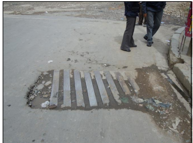
Foto N° 28: Av. Adrian Castillo – Sumidero transversal de calzada colmatado con material.
