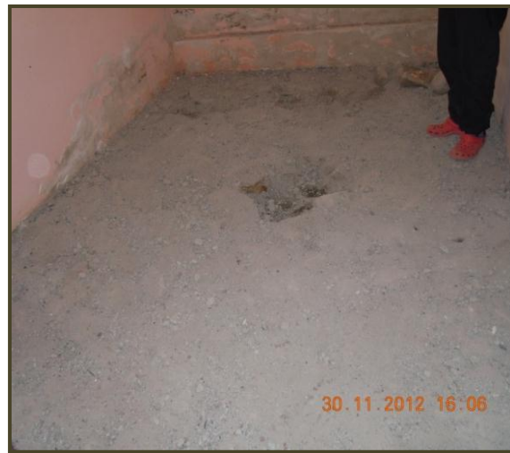
4.- Problemas de humedad en los pisos.
