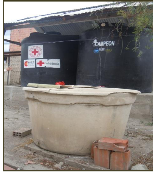
6.-Tanques para almacenamiento de agua.
