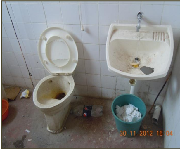
7.- Servicio higiénico en estado de deterioro.
