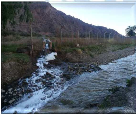
Descarga de la PTAR de Tupiza
