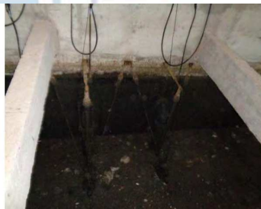
Vista de las bombas sumergibles (presencia de sólidos flotantes y natas)
