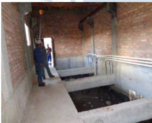
Interior del cárcamo de bombeo
